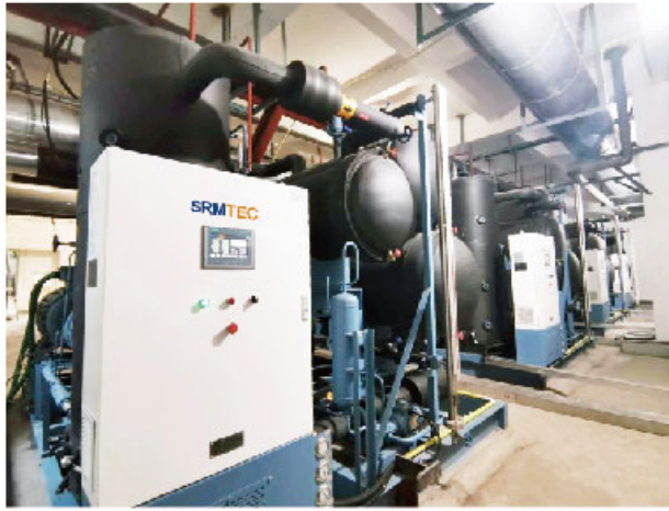
福建某化工热泵项目
