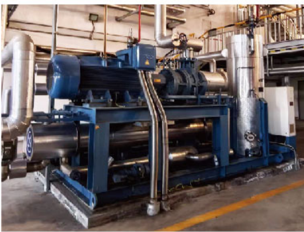
滨州某成套热泵系统项目
