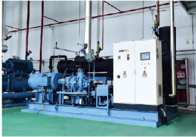
山东某食品热泵项目
