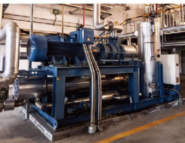
滨州某成套热泵系统项目
