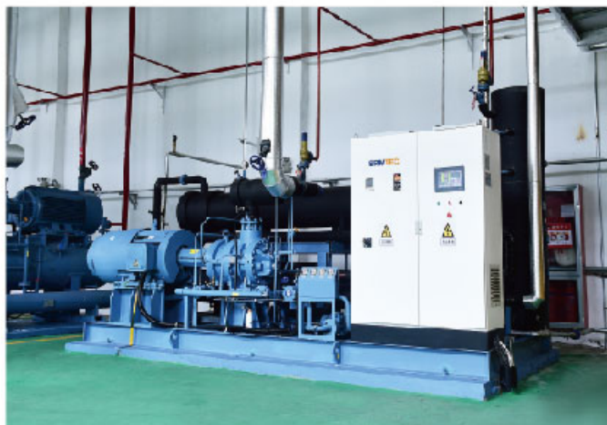
山东某食品热泵项目
