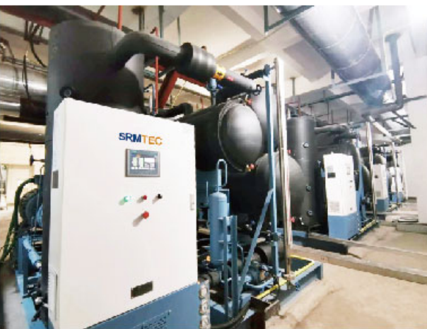
福建某化工热泵项目
