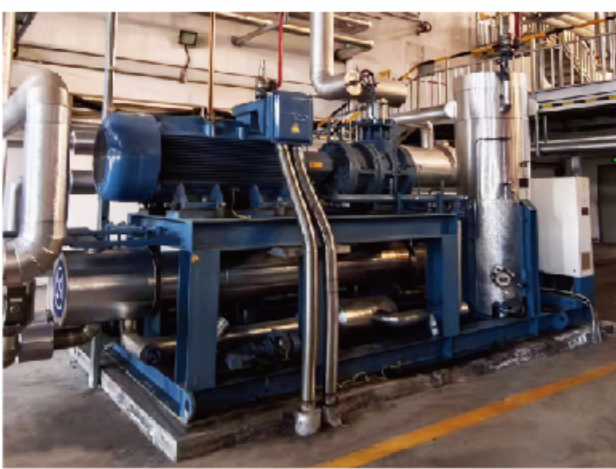
滨州某成鑫热泵系统项目
